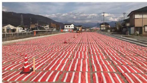
甲府市内のバイパス工事での路盤補強と振動対策（水）2017年3月
