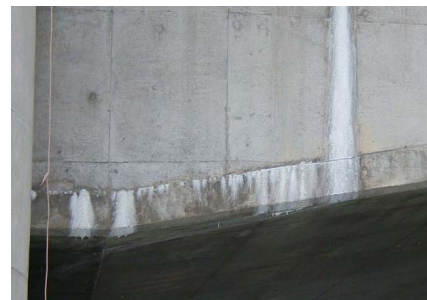
写真-3 P3 ウェブ漏水状況
