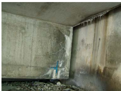
写真-1 伸縮継手部遊離石灰
