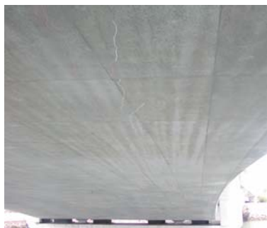
写真-2 P 2～3 径間ひび割れ状況
