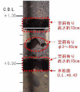
写真-4 改良体の未改良部分 (孔内撮影)
