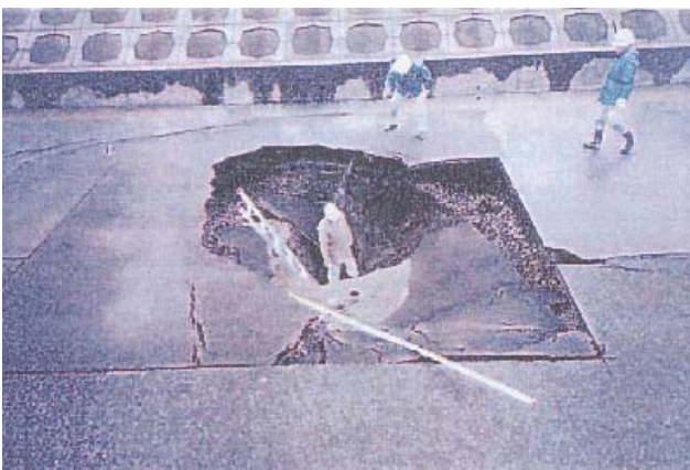
写真-2 背後地の陥没状況
