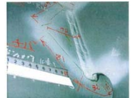
②スリットまわり溶接部トラフリブ側端に発生した亀裂
