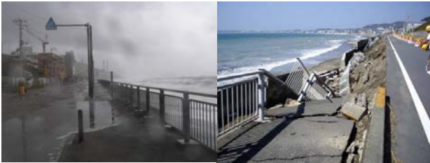
図-2 台風0709号による越波被害及び護岸倒壊状況
