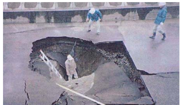
図-2 護岸部の吸出しによる影響
