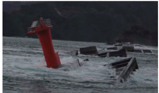
図-6 釜石湾口防波堤の北堤の被災状況
