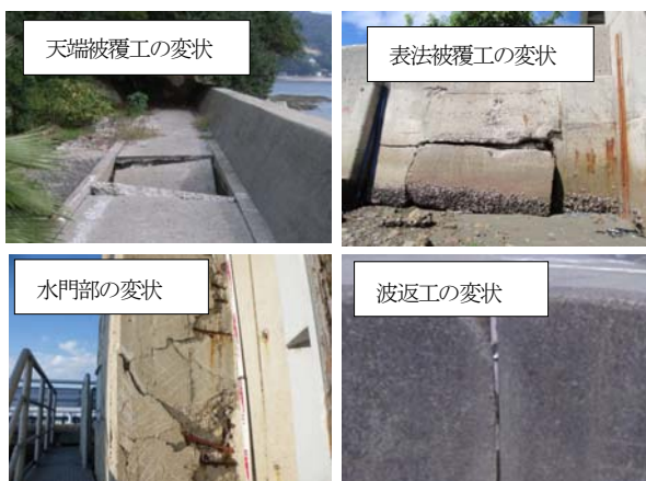
写真-1 海岸保全施設の老朽化に伴う変状
