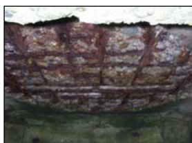
栈橋床版下面鉄筋露出 (50年経過)
