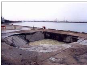
裏込め土の吸出しによるエプロンの陥没
