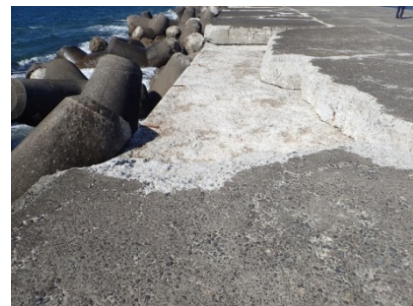
写真-5 防波堤上部コンクリート損傷の例
