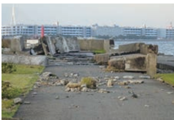
図1 後退パラペットの倒壊（本牧D突堤）
