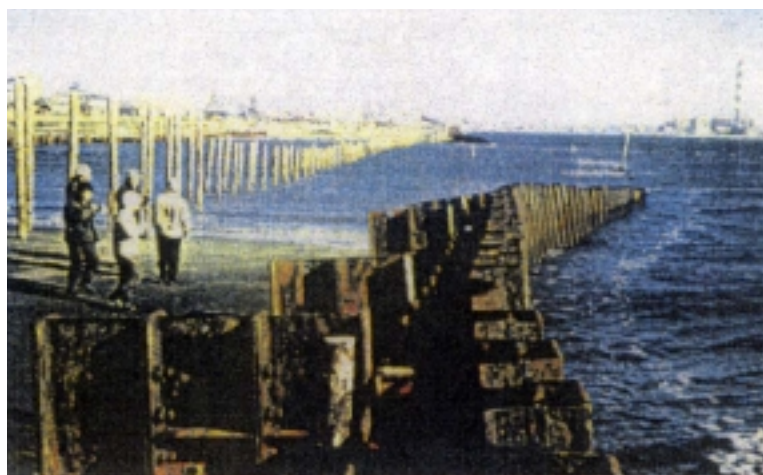
図-1 岸壁の破壊例
