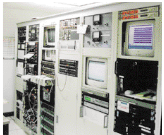
写真 - 5 警報センター内部
