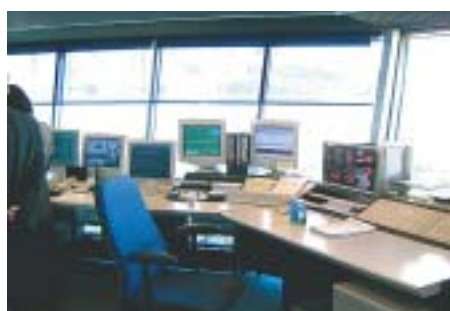
写真2 コントロールセンター
