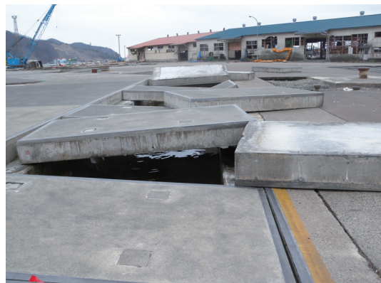
写真5 【釜石港】岸壁の損壊
