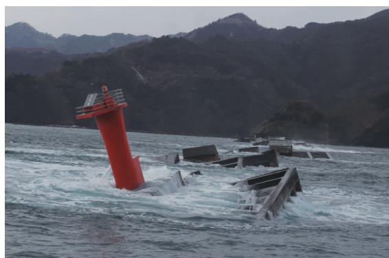
写真6 釜石湾口防波堤（沈下・滑動した北堤ケーソン）
