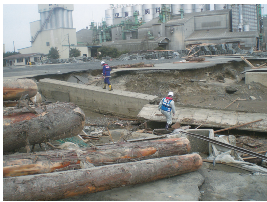
写真4 【石巻港】岸壁の損壊
