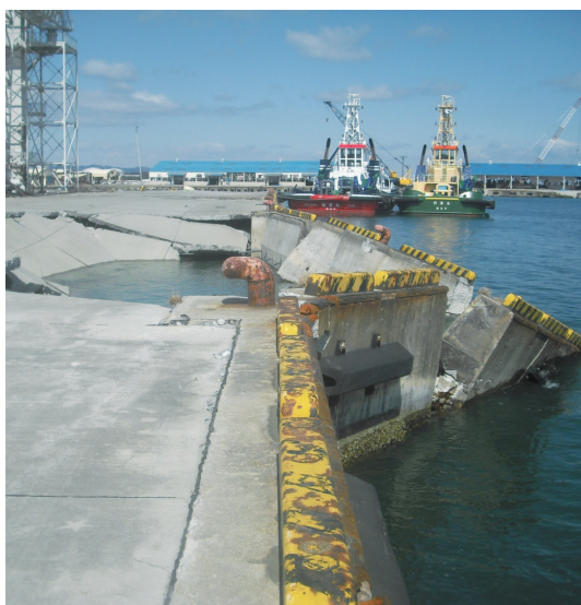
写真8 【相馬港】岸壁の倒壊
