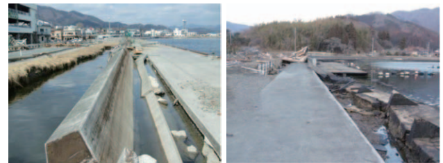
(a) 背後地盤の洗掘 (b) 前面地盤の洗掘
