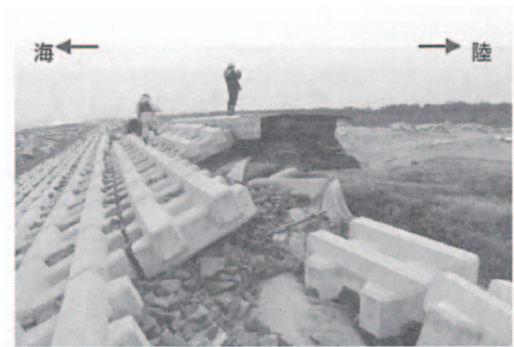
図6 三面張防潮堤の被災
