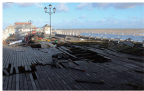
写真8 クローマー栈橋を襲った高潮・高波被害(2013年12月)BBCニュース映像より
