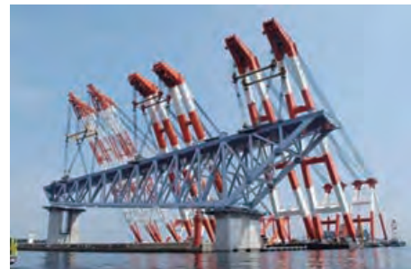
写真-1 大型起重機船3隻相吊りによる東京ゲートブリッジの架設
