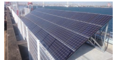
太陽光発電システム外観@Y-CC屋上
