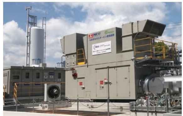
図5 水素コージェネレーションシステム
