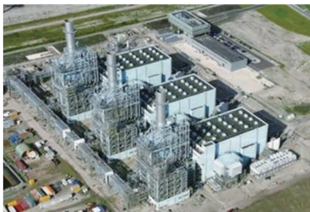
図9 オランダのバッテンフォール・マグナム発電所
