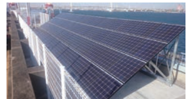
太陽光発電システム外観@Y-CC屋上
