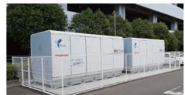
自立型水素燃料電池システム外観
