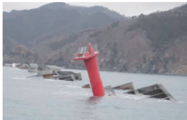
東日本大震災により被災した防波堤(釜石港湾口防波堤)
