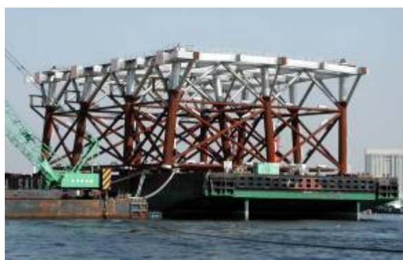
図-3 ステンレス鋼ライニングを適用したジャケット式栈橋構造物（大井埠頭新5コンテナバース）
