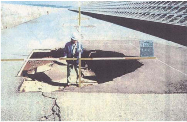
写真-2 護岸天端の沈下
