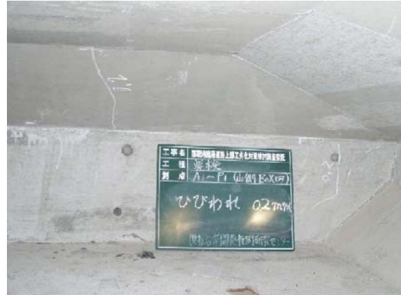
写真-3 隔壁部劣化状況
