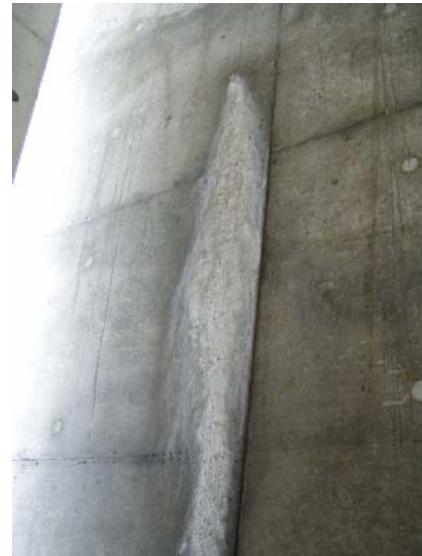
写真-6 P3WEB 劣化状況
