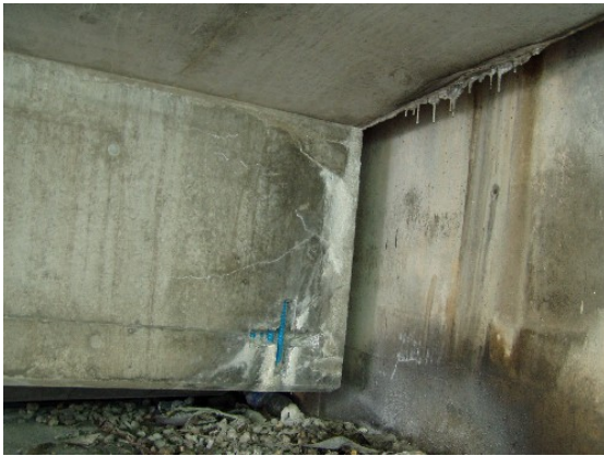
写真-5 A1 桁端部における遊離石灰
