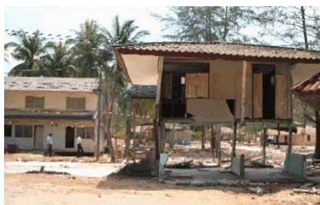
図-6 一階部分が柱のみ残る木造建物
