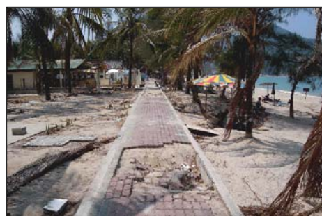
図-4 吸出で損壊した遊歩道
