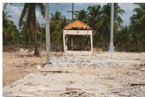
図-8 海に面する方向の壁が崩壊した建物
