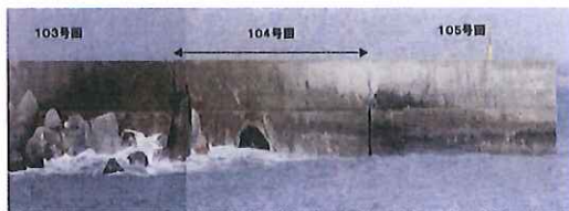
写真-4 宮崎港 ケーソン穴あき (104号函)
