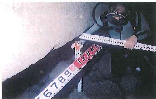
写真-2 片泊港 ケーソン基礎捨石の洗掘
