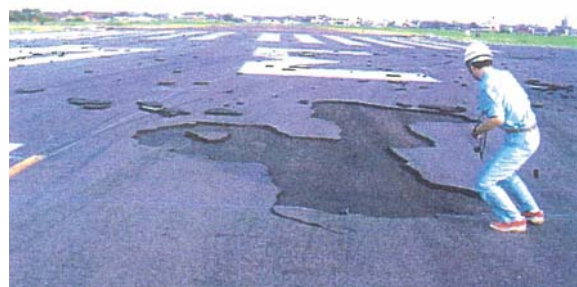
写真-1 剥離状況(H12.7.2)
