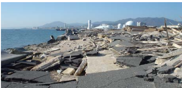
写真-2 護岸の被害
