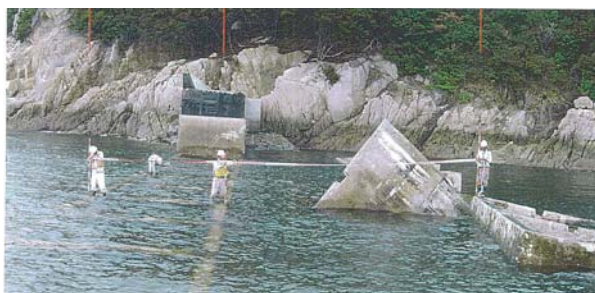
写真-1 防波堤の被害
