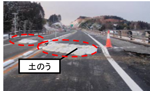
三陸道における対応（東北地方太平洋沖地震）
