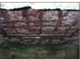
栈橋床版下面鉄筋露出 (50年経過)
