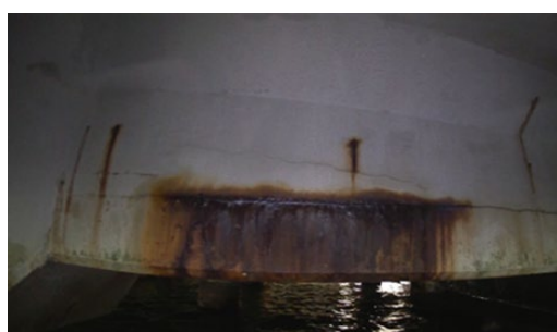
写真- 9 栈橋上部工下面の剥離状況②
