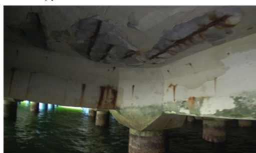
写真- 8 栈橋上部工下面の剥離状況①
