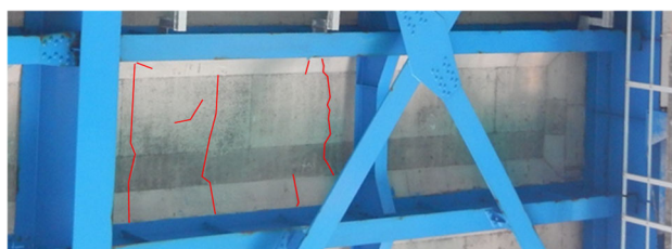
図-5 床版下面状況 (No. 210 パネル) ※ひび割れの一部を赤線表示
