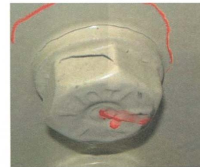
写真－Ⅱ. 2. 14 高力ボルト部の塗膜割れ(2)
