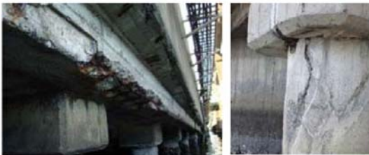
鉄筋コンクリート桁における 主要な鉄筋の腐食 橋脚部にお コンクリートのひ
