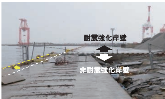
図2 地震対策(仙台塩釜港)
