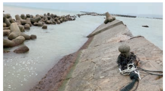
飯田港(飯田地区)東防波堤の被災状況(重力式区間)
