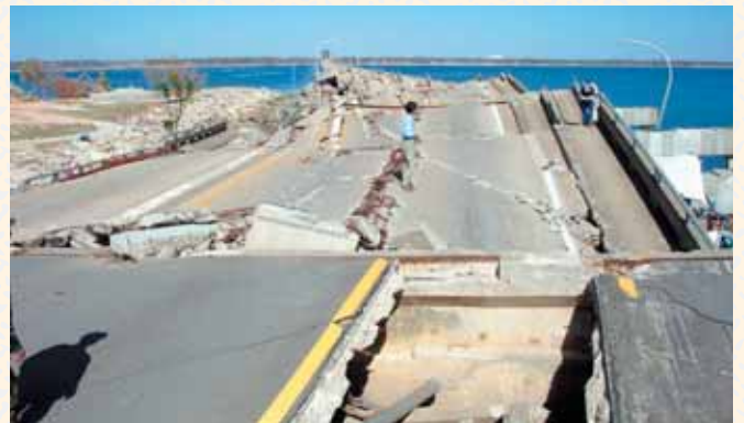
ハリケーンカトリナによる被災状況
