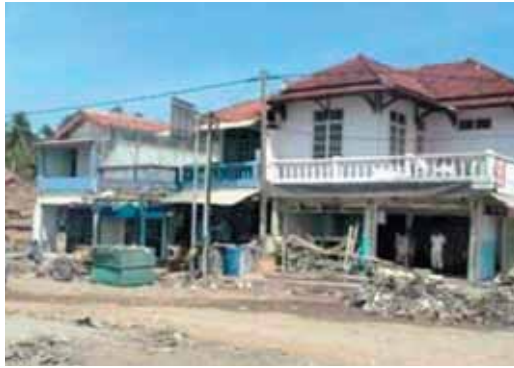
写真-4 海岸に面した家(1階の壁の破壊)
