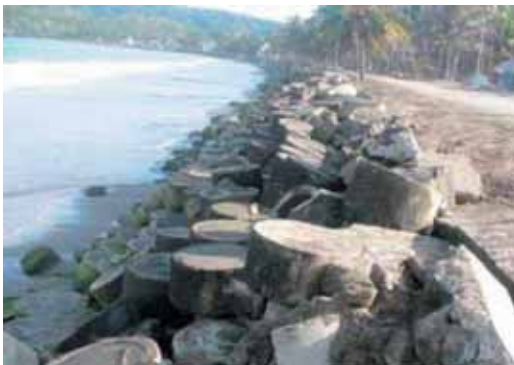
写真-6 壊れた護岸(Pangandararan)
