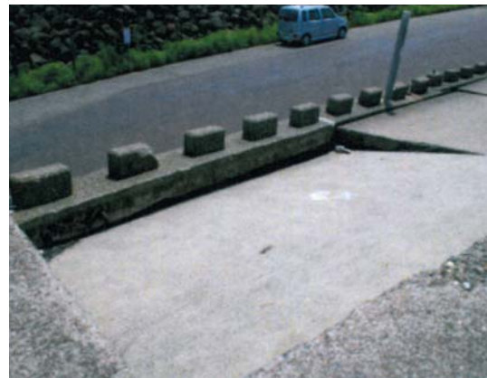
写真 - 8 コンクリート版の陥没
