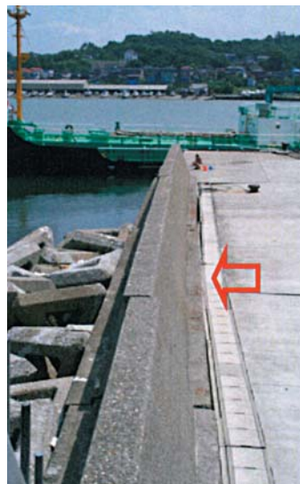
写真 - 1 西埠頭 沖側護岸の移動状況
