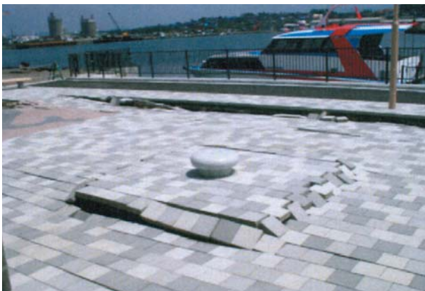
写真 - 10 インターロッキングブロック被災(2)
