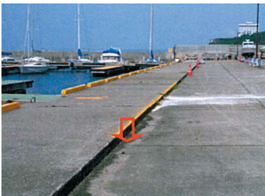
写真 - 15 エプロンの沈下
