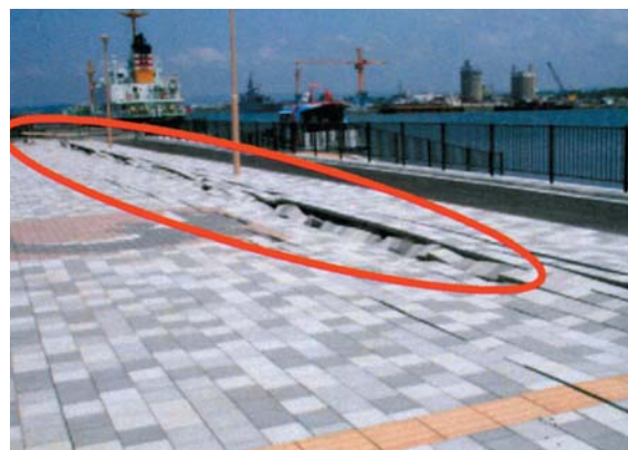
写真 - 9 インターロッキングブロック被災(1)
