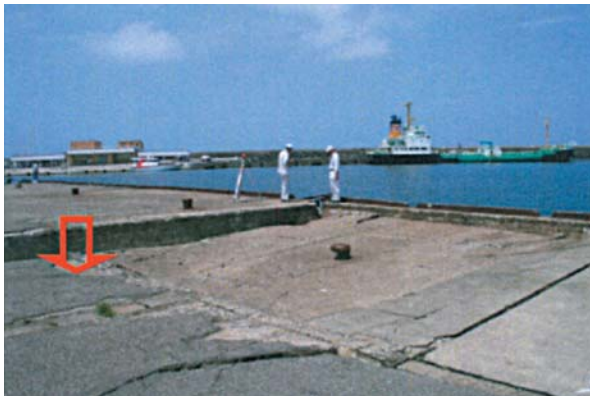
写真 - 12 沖側岸壁近傍の沈下
