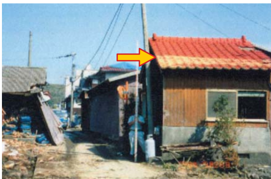
写真 - 1 屋根まで浸水した住宅
