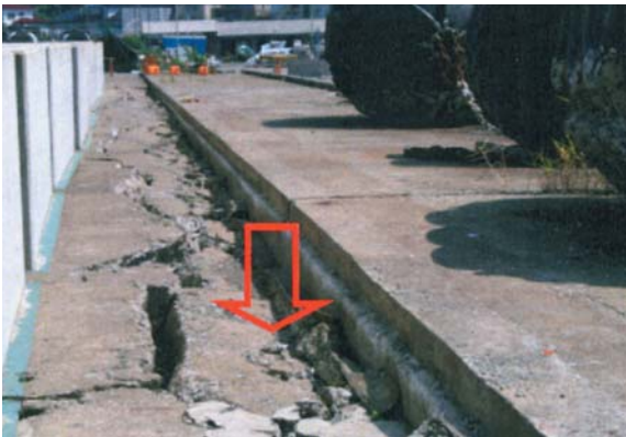
写真 - 13 エプロンの沈下
