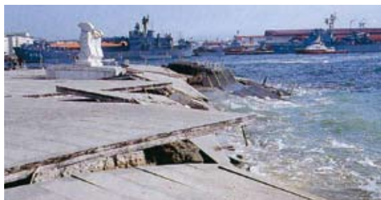
写真1 1995(平成7年)兵庫県南部地震による被災護岸
