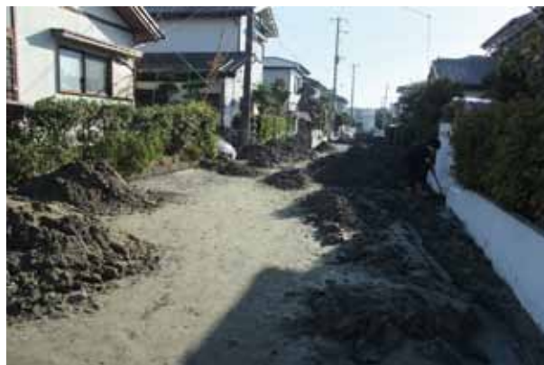
写真1 多量に発生した噴砂(千葉市、地震の2日後)
