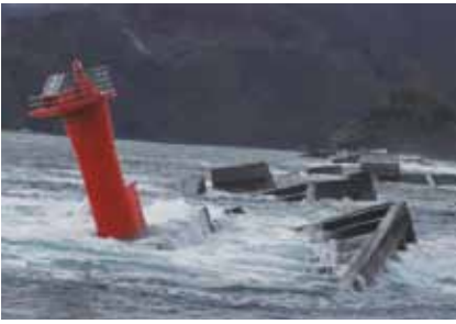
写真6 釜石湾湾口防波堤の北防波堤の被災状況
