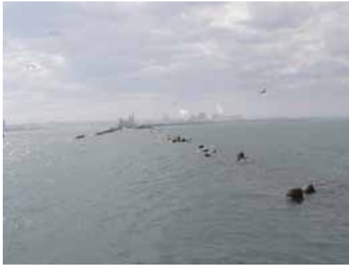
写真1 八戸港北防波堤の中央部の被災状況
