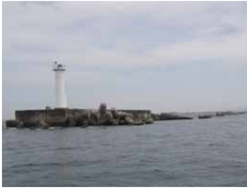
写真2 相馬港沖防波堤の被災状況
