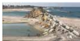
東日本大震災における堤防の破壊
