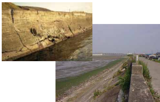
写真1 海岸保全施設の老朽化の状況
