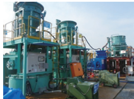
写真1 HCB-Fの製造プラント
