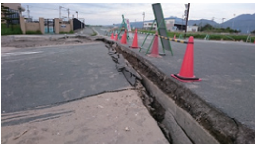
図1 臨港道路で発生した段差(熊本港)
