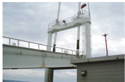
図2 フェリー埠頭の可動橋を支えるシャフト
