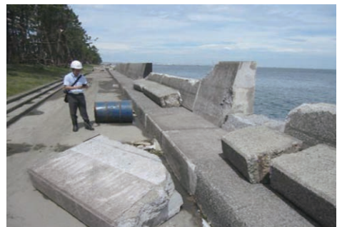
図-1 横浜港における高波による護岸倒壊事例 （令和元年房総半島台風）
