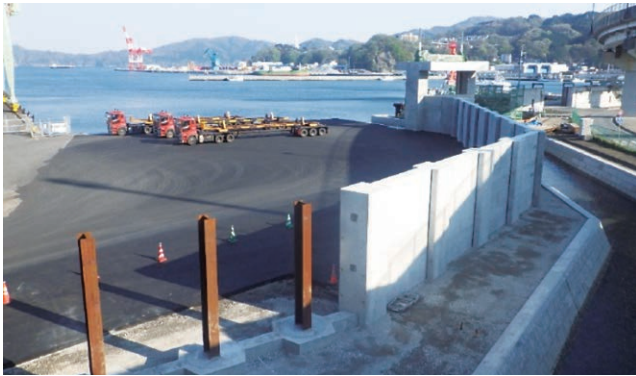
図7 差し込み式防潮堤(釜石港)
