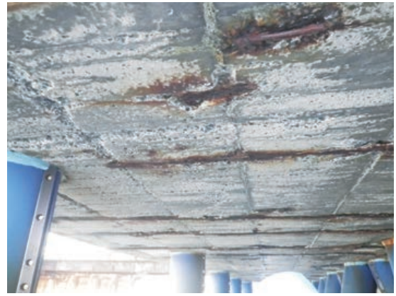
写真3 港湾構造物の塩害劣化の例
