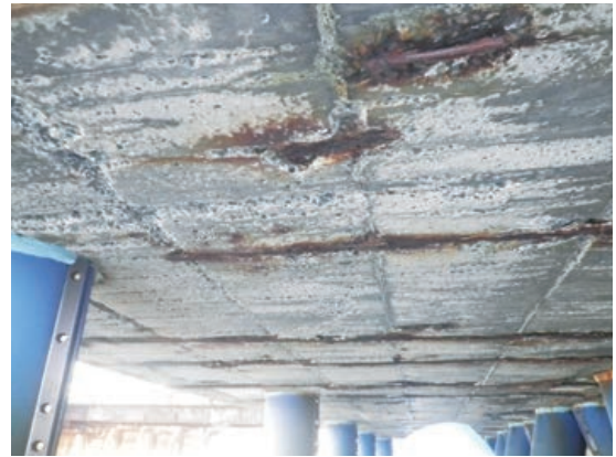
写真3 港湾構造物の塩害劣化の例
