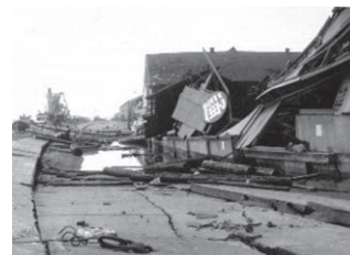
北ふ頭物揚場と上屋の損壊
