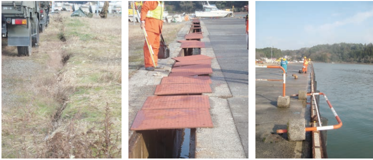
写真2 穴水港の栈橋(-4.0m, 土留めは控え直杭式矢板式)の被害。左は控えの位置のクラックを示す。
