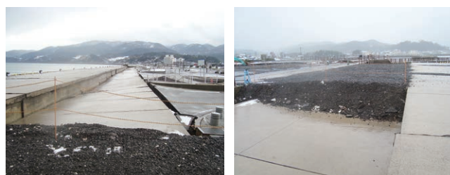
写真1 輪島港のケーソン式岸壁(-7.5m)の被害(左)と応急対策(右)
