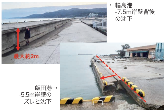
写真1 港湾の被害状況(出典：国土交通省HP)
