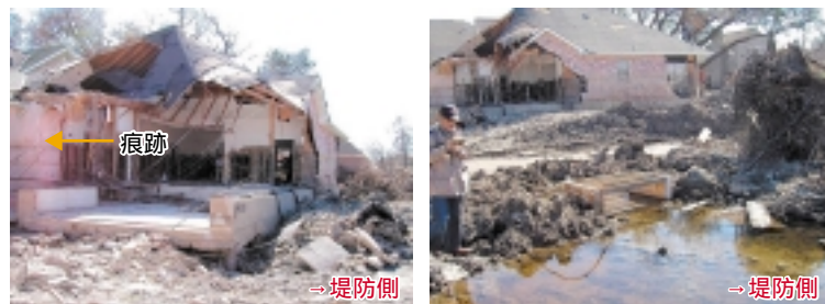
(c) 破堤箇所の直背後にある住宅
