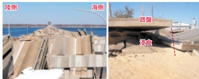
写真-10 ピロキシと対岸を結ぶ橋桁の落下
